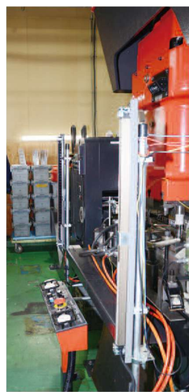
事故防止の為、操作盤の右側にはセンサーが
